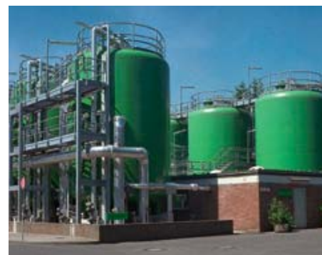
Die Filteranlage im Wasserwerk Flehe. Neben Energie zählt die Versorgung mit Trinkwasser zum Kerngeschäft der Stadtwerke Düsseldorf. Dazu werden insgesamt fünf Wasserwerke betrieben.
